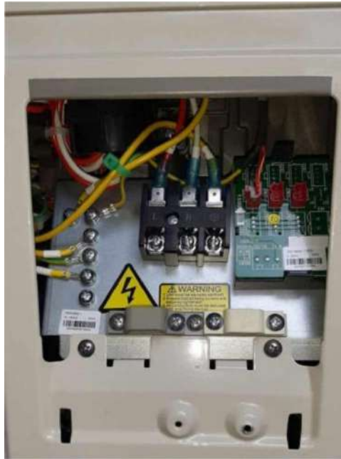
Wygląd części elektrycznej jednostki zewnętrznej (zdjęcie powyżej)
