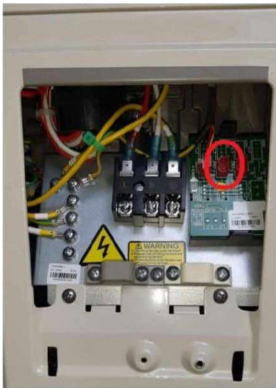
Jednostka zewnętrzna pompa ciepła M&amp;S POWER
